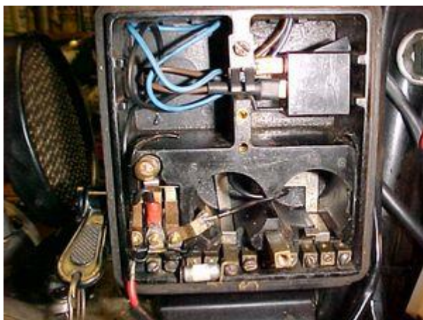
Das Relais kann in den Schaltkasten, aber auch an jede andere Stelle.
